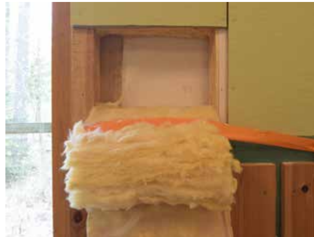
Kuva 34. Kuvassa avauksessa näkyy alimmaisena valkoiseksi maalattua pahvipintaa, purku olisi tehtävä siihen asti.
