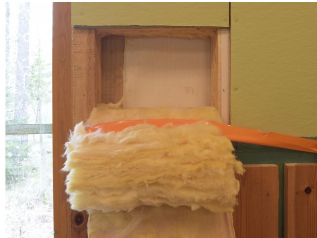
Kuva 34. Kuvassa avauksessa näkyy alimmaisena valkoiseksi maalattua pahvipintaa, purku olisi tehtävä siihen asti.
