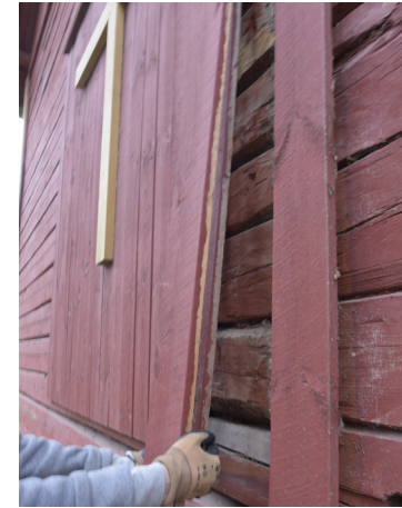
Kuva 37. Kurkistus päädyn lautojen alle.
